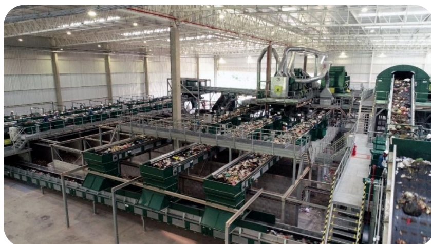
Foto: Unidade de Triagem Mecanizada de Jaboatão dos Guararapes.
