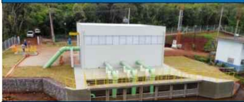
SAA Campo Mourão - Captação
