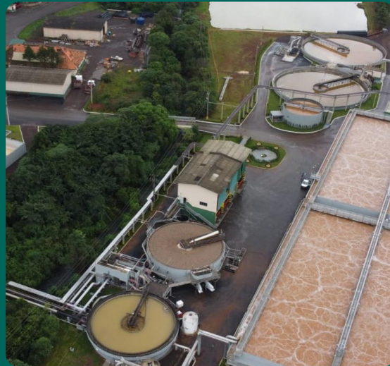
MDL ESTAÇÃO DE TRATAMENTO DE EFLUENTES
