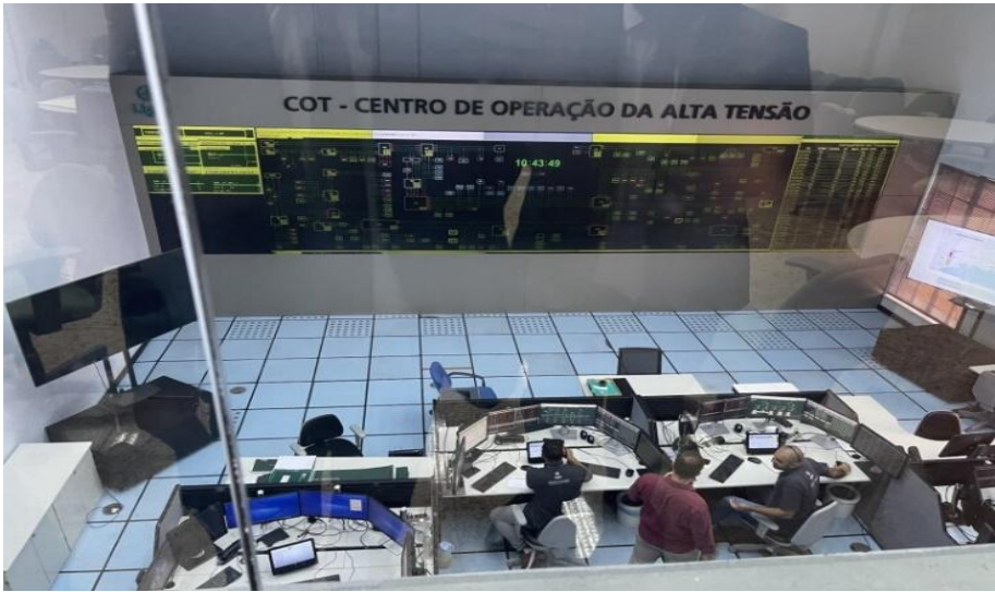
Figura 4 - Centro de Operação de Alta Tensão – COT
