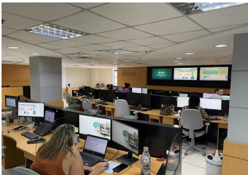
Figura 3 - Centro de Controle
