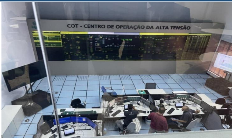
Figura 4 - Centro de Operação de Alta Tensão – COT
