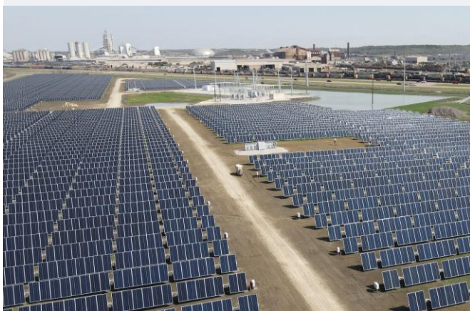
Painéis Solares e Planta de Midlothian
