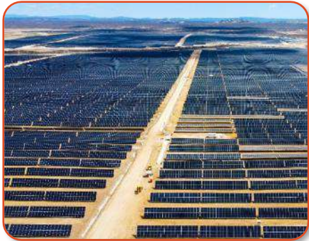
Complexo Solar Futura I - BA
