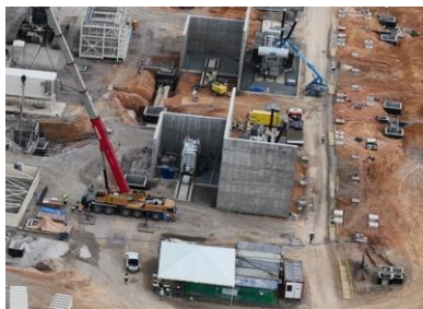
GTG11 - Posicionamento do Trafo Auxiliar 11BBT
