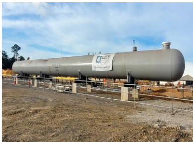
Posicionamento Slug Catcher na base
