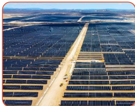
Complexo Solar Futura I - BA
