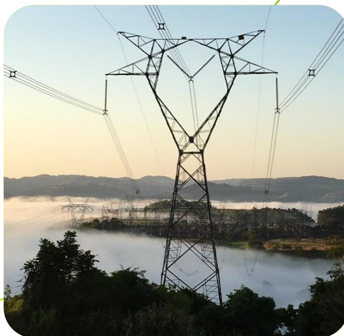
Torre Itá-Salto Santiago | CGT Eletrosul
