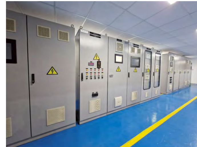
Foto 3 – Sala de painéis
