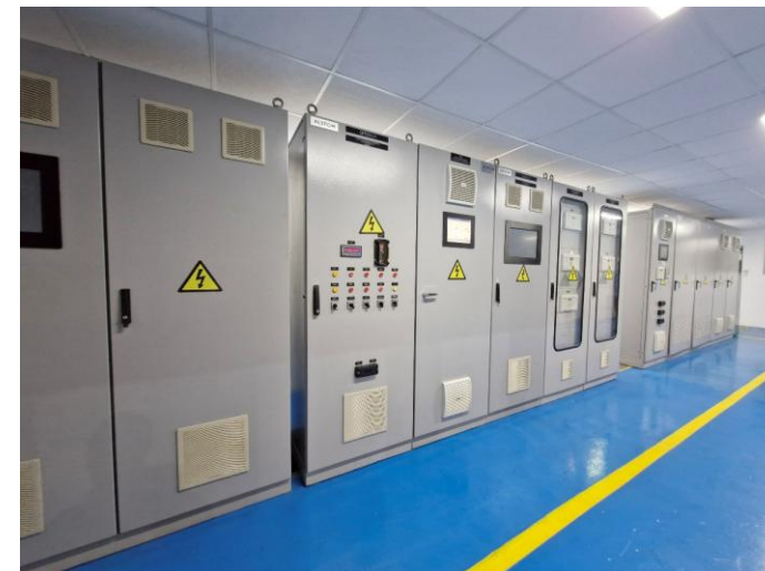
Foto 3 – Sala de painéis
