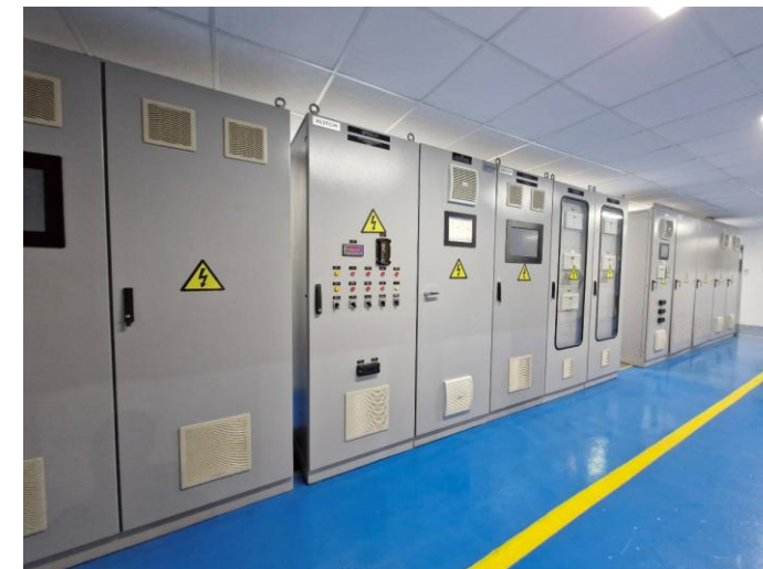
Foto 3 – Sala de painéis
