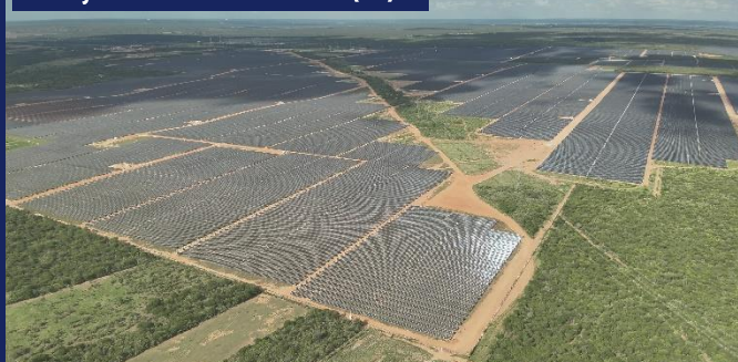
Conjunto Fotovoltaico Assu Sol (RN)
