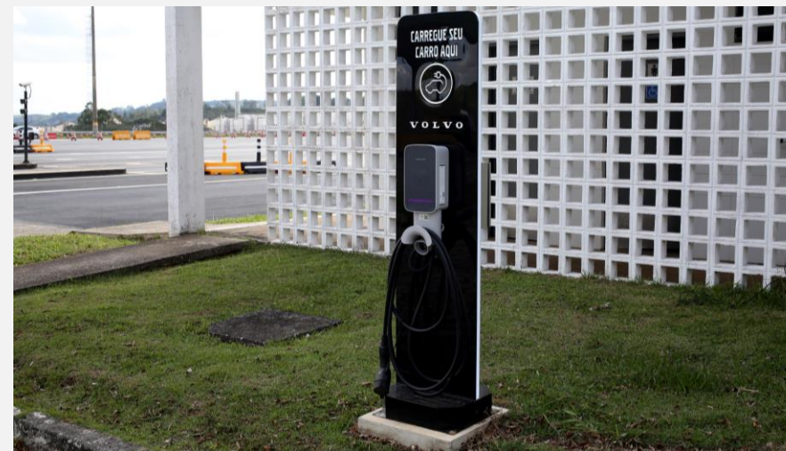
Carregador elétrico instalado em unidade do Grupo EcoRodovias
