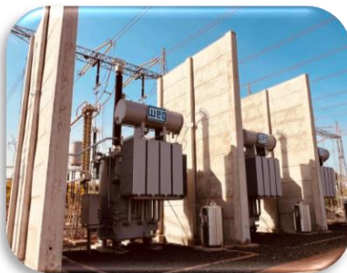
SE São Simão Novo Reator 500kV
