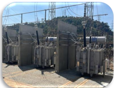
SE Taquaril Novos transformadores
