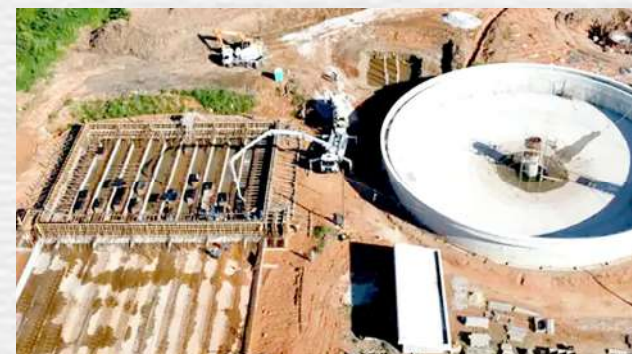
ETE Potecas, São José
